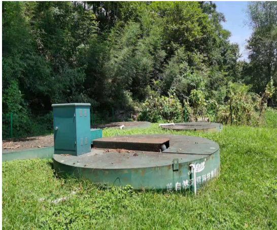
图 1 200t/d 污水处理站
