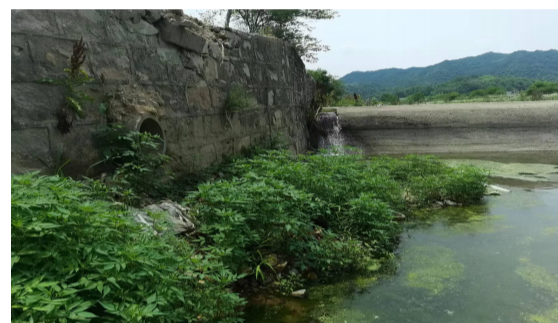
槐树湾河拦水坝（入河排污口）
